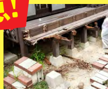
外部ウッドデッキ被害
