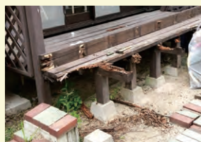
外部ウッドデッキ被害
